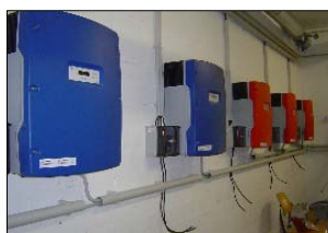
26.10.2006 Die Montage der Module ist abgeschlossen, nun stehen noch letzte Kabelverlegungsarbeiten und die abschließenden Installationsarbeiten im Bereich der Wechselrichter an.
